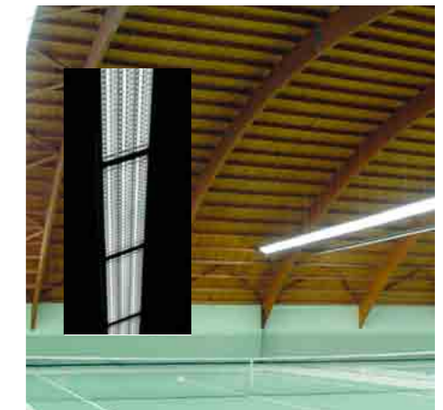
TC Vierjahreszeiten, Hamburg – ARTEKO® LED-Leuchtröhren in Leuchtröhrenträger Sport, 3-flammig
